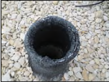
Photo N° 346 AMIANTE CIMENT -- TOITURE TERRASSE Toiture Ventilation haute (Fibres-ciment)
